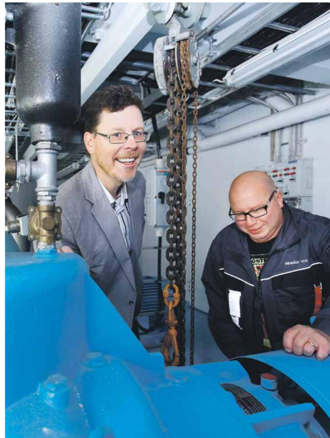
▲ Vesilaitoksen johtaja Jarmo Rämö (vas.) ja laitospäällikö Arii Kallilainen tutkivat Herajoen vedenottamon puhdasvesipumppua, joks pumppaa vettä Herajoen laitokselta verkostoon.
